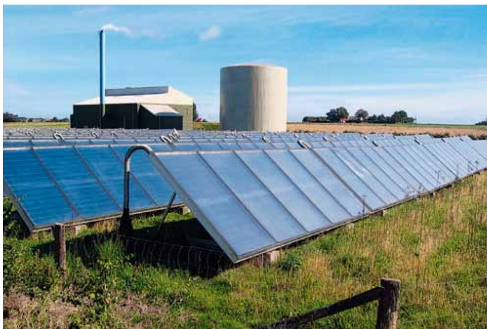
På norra Samsö kombineras bioenergi och solenergi i en fjärrvärmeanläggning som bland annat förser fritidshus med tappvarmvatten.
